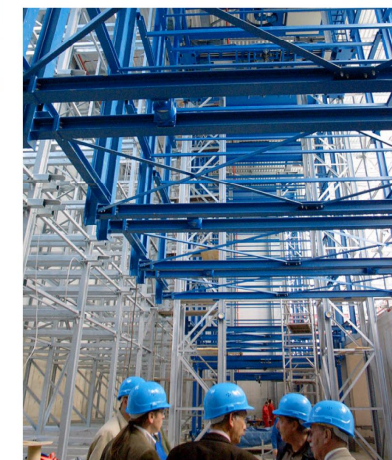
Innen erinnert das automatische Parkhaus in Dresden an ein Hochregallager. Foto: zvg
